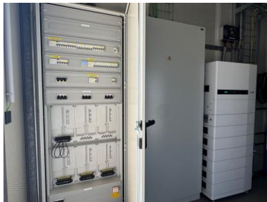
Zähler- und Verteilerschrank
